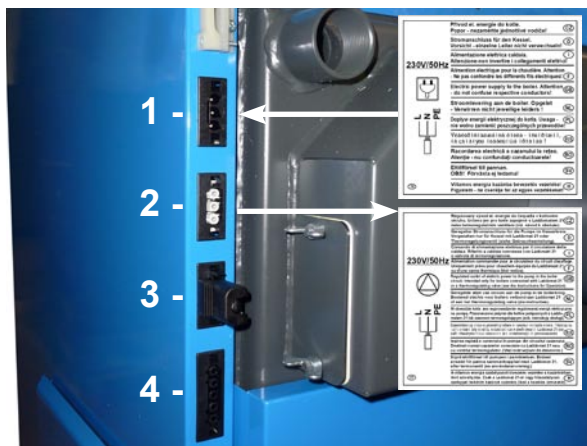
Konektory v pravé kapotě kotle
