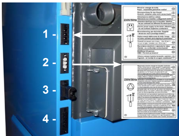
Konektory v pravé kapotě kotle
